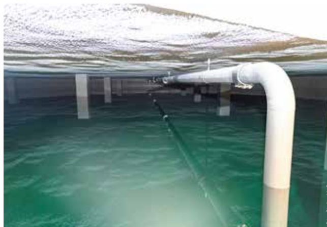
Das neue „Innenleben“ des Hochbehälters.
